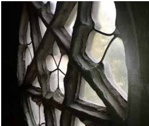
Giebelrosette, Innenansicht 2020: Ihr Zustand erlaubt nur substanzerhaltende Massnahmen (ds, 18.9.2019)
