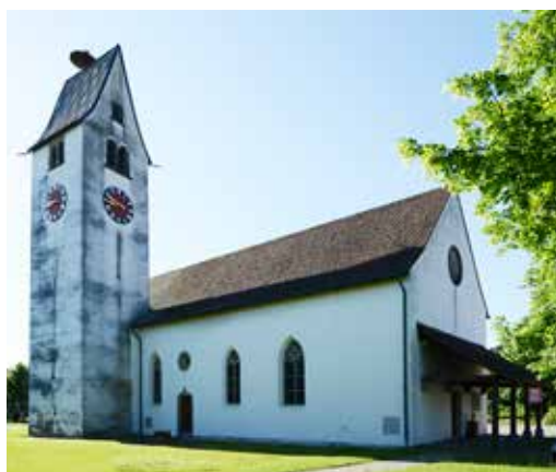
Ref. Kirche Brittnau: Nordfassade des Kirchenschiffs und Turm unmittelbar vor der Sanierung (fs26, 29.5.2020)
