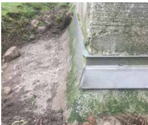
Sockel am Kirchturm freigelegt vor Aufbau des Fassadengrüstes, Spenglerblech und Kitt als Sockeldetail (ds, 19.5.2020)
